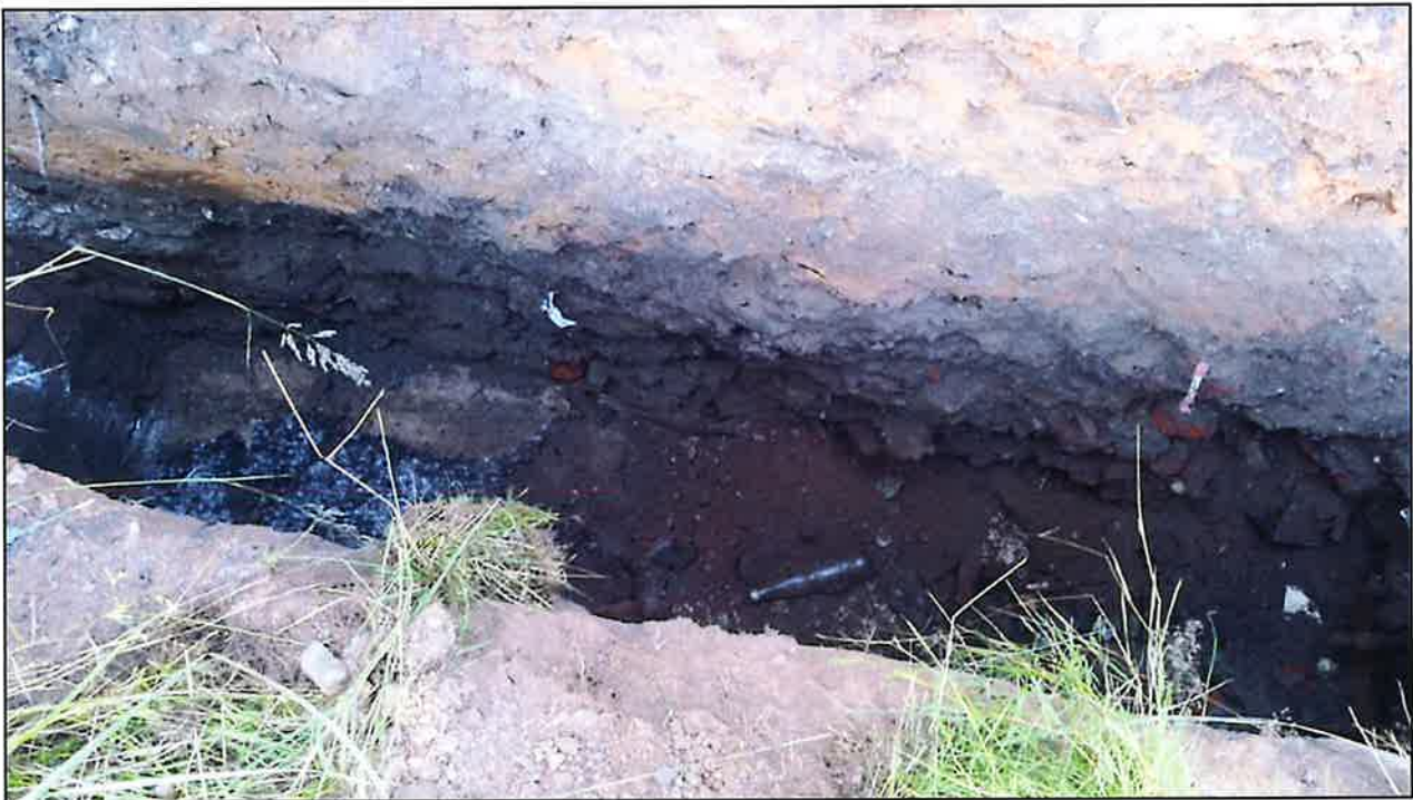
Abbildung 5: Auffüllung aus Hausmüll, Schwarzdeckenaufbruch und Ziegelbruch in BS 1
